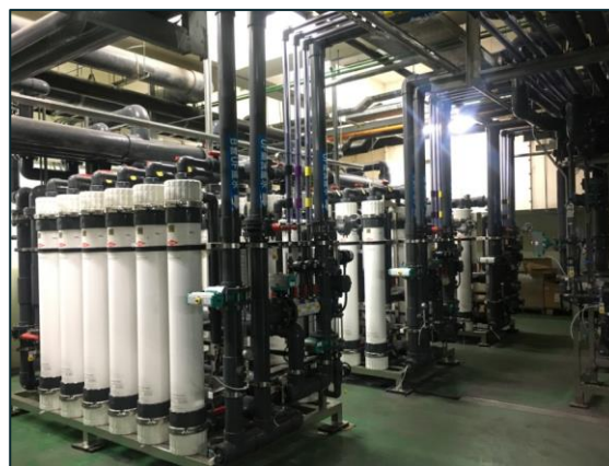
3C廠區UF系統照片
