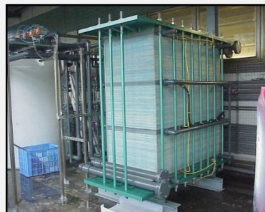
RO 濃縮水 (300 CMD)
