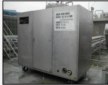
RO 濃縮水 (300 CMD)
