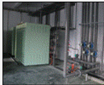
PCB 廢水 (1,200 CMD)
