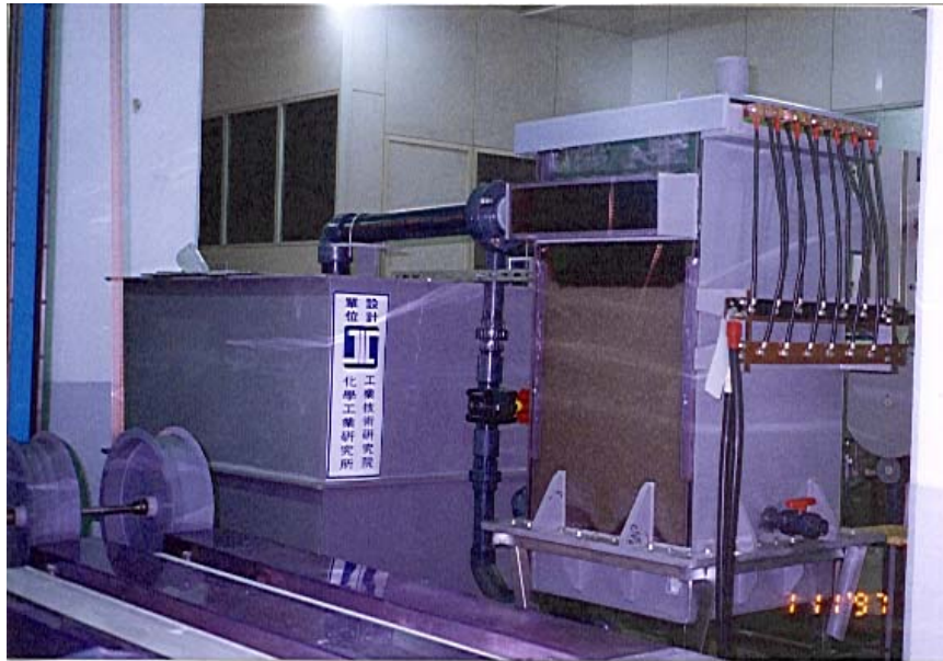
流體化床線上電解回收設備(銀回收量10公斤/天)
