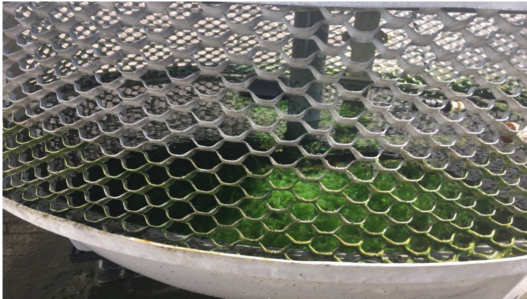
冷卻水塔設備故障 長期漏水甚至已生長青苔
