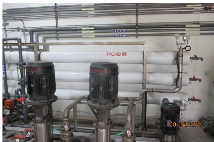
圖 25 奈米過濾處理系統設備圖
