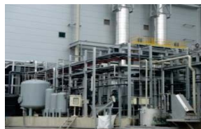
中華映管陽梅廠廢水處理與回收
