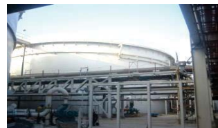
台塑石化麥寮廠高鹽MBR廢水處理
