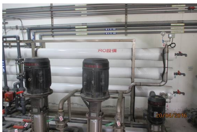
圖 29 奈米過濾處理系統設備圖
