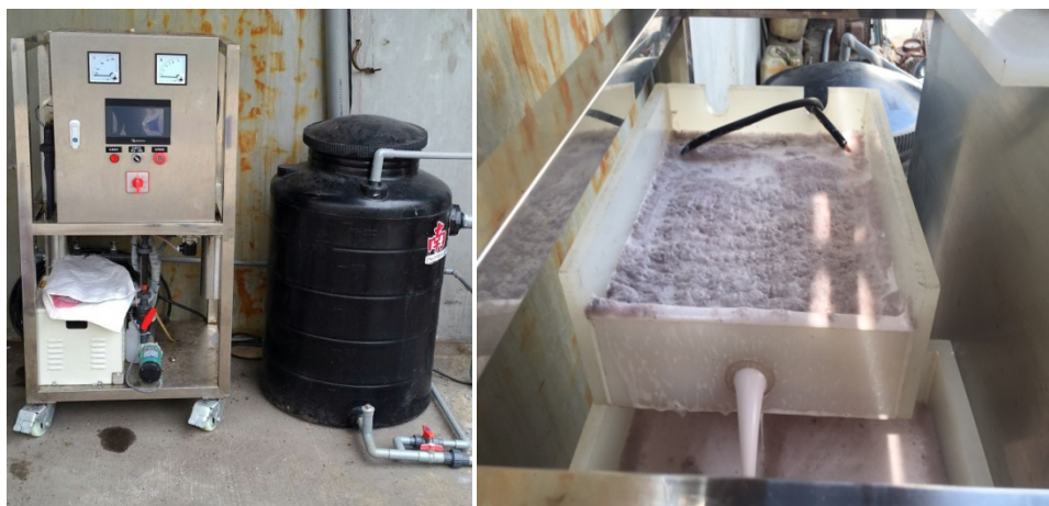
圖 29 電混凝系統實廠模組
