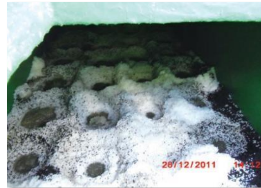
好氧槽-海棉擔體 (MBBR)
