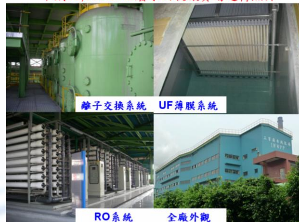
中鋼13,500CMD廢水回收廠實場運轉照片
